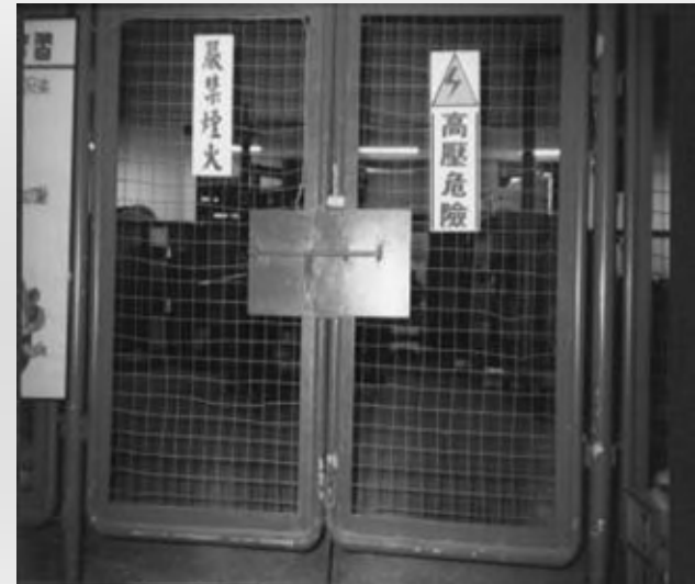
高壓試驗場以鐵網圍住並標示警告
