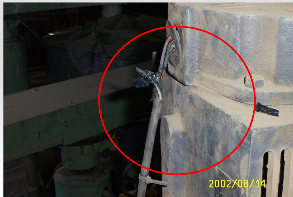
攪拌器電源線裸露部分
